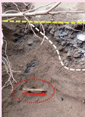
1本の根がコンクリート基礎の下を潜り抜けています。約70cmもある基礎の先へ根が伸長していることから、石戸蒲ザクラが根を北に伸ばそうとしているのがわかります。
