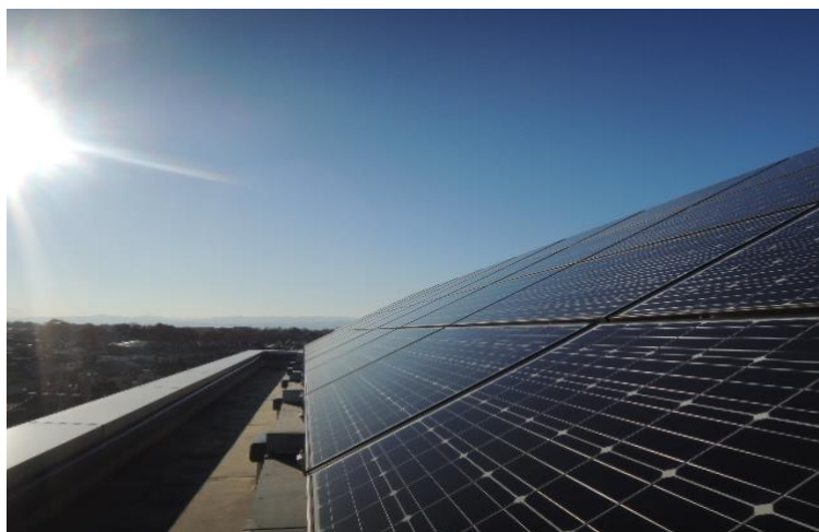
▲庁舎屋上の太陽光発電システム
