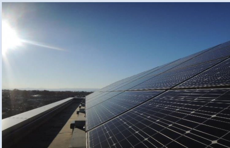
▲庁舎屋上の太陽光発電システム
