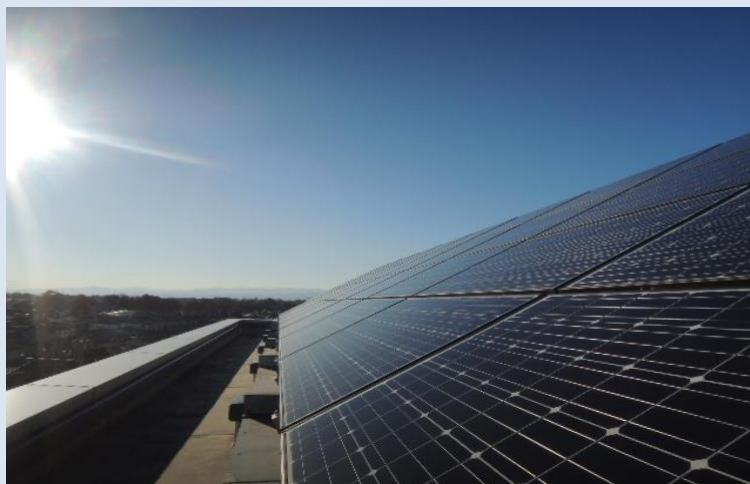
▲庁舎屋上の太陽光発電システム
