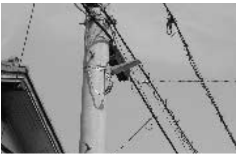
新たに設置されたLED街灯
