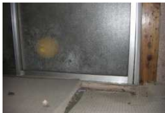
①床下の根太が折れ畳が陥没
