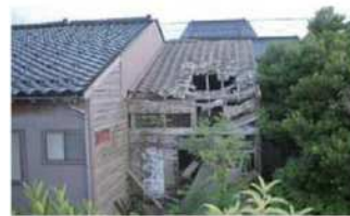
③屋根の落下、落ち込み
