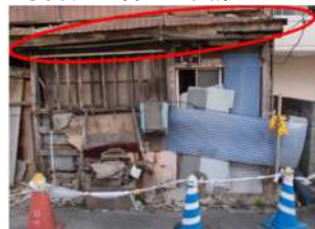
⑤軒に不陸、剥離
