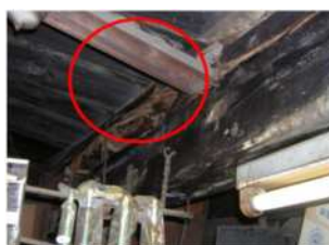
②はりの破損、腐食
