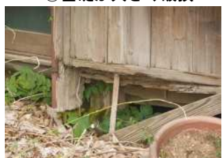
⑥基礎の破損
