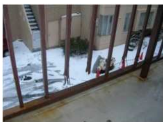
②バルコニー手すりが腐食
