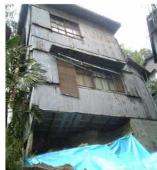
③基礎が大きく欠損
