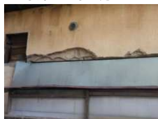
⑥外壁の剥落、破損
