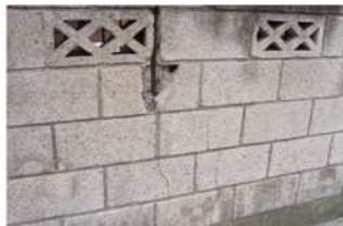
②塀に大きなひび割れ
