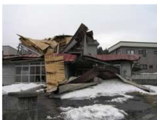
①屋根が落下した空き家
