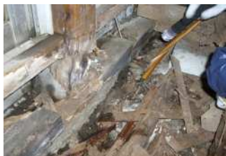
②湿気等が原因で床下腐朽
