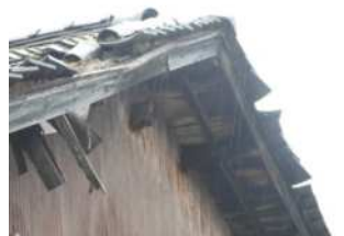
⑦屋根ふき材の破損
