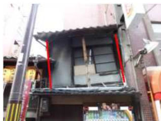
②2階沈み込み、傾斜
