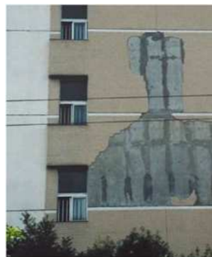
③外壁が剥落
