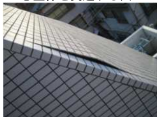
④外壁に浮き発生
