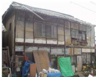
②雨樋の著しい変形
