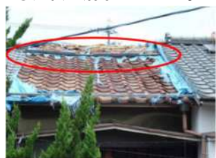
④屋根ふき材に剥離、脱落
