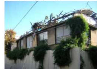
⑥屋根ふき材の破損
