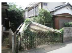
④カーポートの崩落
