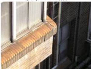
⑤外壁に浮き発生
