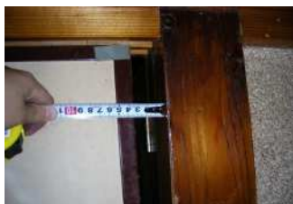
①柱の傾斜で襖が閉まらない
