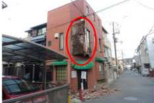
②外壁が破損
