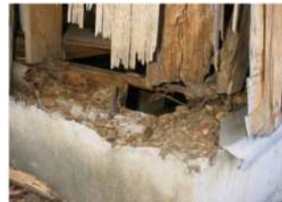
③蟻害が発生し欠損
