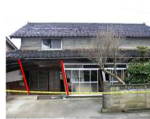
③1階部分が傾斜
