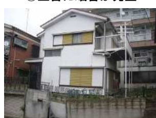
⑦基礎が大きく破損
