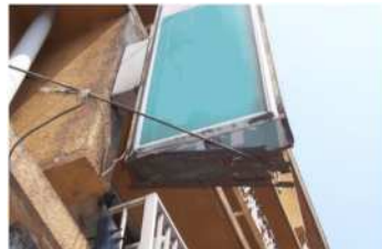
②底板が腐食
