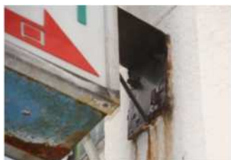
①支持部分に著しい腐食
