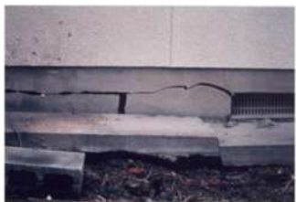
④基礎が大きく破損
