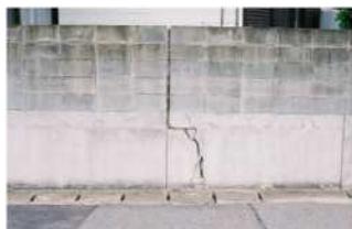
①塀に大きなひび割れ
