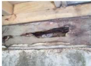
⑤土台に蟻害が発生
