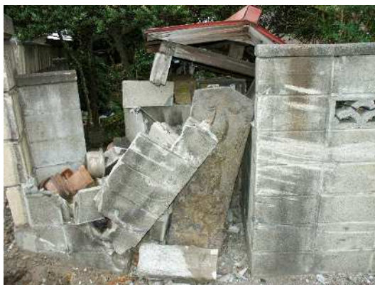
庚申塔の毀損状況(平成 16 年)
