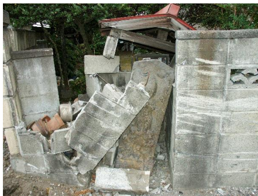
庚申塔の毀損状況(平成16年)
