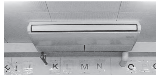
各教室に設置したエアコン
