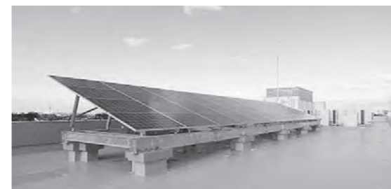
各学校に設置した太陽光発電設備
