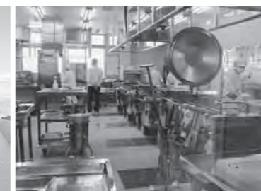
西中自校方式給食室内部
