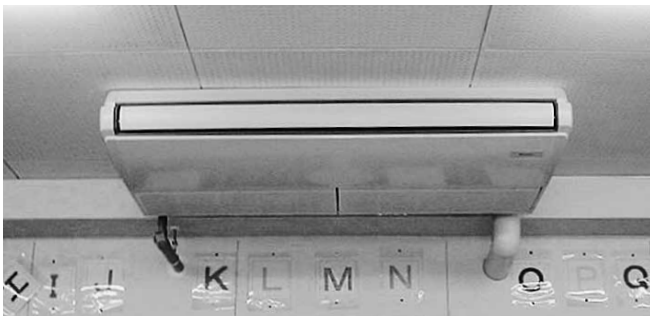
各教室に設置したエアコン
