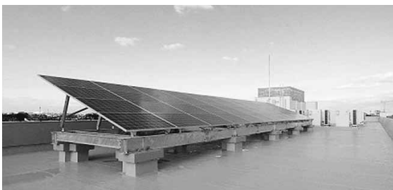
各学校に設置した太陽光発電設備
