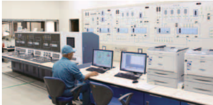
中丸浄水場 中央管理室
