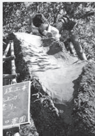
腐朽部を直接モルタルでふさいだ状態(昭和57年)
